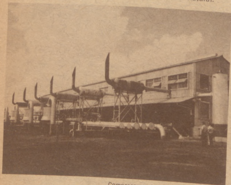
Compresores de la Planta de Chimire.
